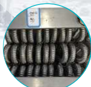
11排冷凝回收装置/减少热损耗
